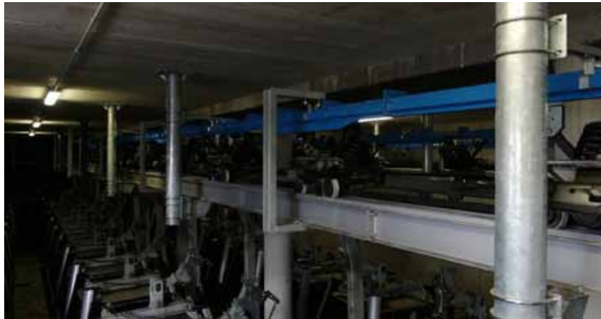
Dettaglio di una rotaia di scorrimento in magazzino
