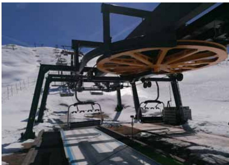
Stazione rinvio di una seggiovia ad ammortamento fisso
