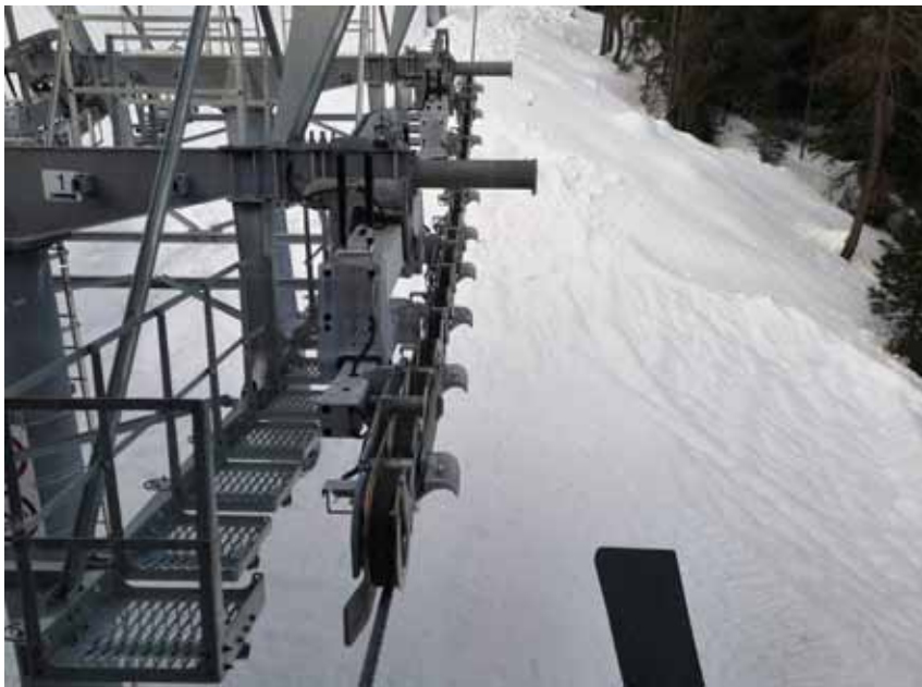
Dettaglio del circuito di sicurezza di linea con barrette antiscarrucolamento e scarpetta raccogli-fune
